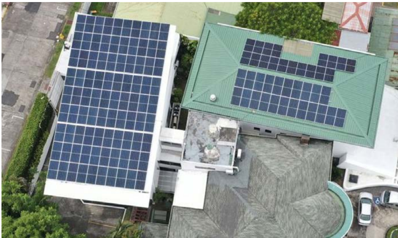
Vista aérea de los paneles fotovoltaicos en las instalaciones de la Corte.
